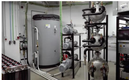
Imagen 26: Sistema de Aprovechamiento de Calor
