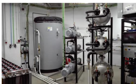
Imagen 17. Sistema de Aprovechamiento de Calor.
