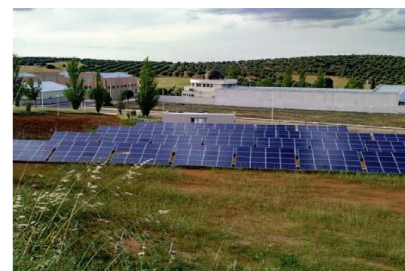
Imagen 20. Planta fotovoltaica 100 KW.
